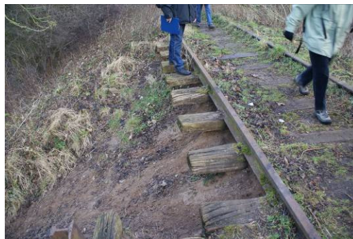
Figur 5 - Den skadede banedæmning. 3
